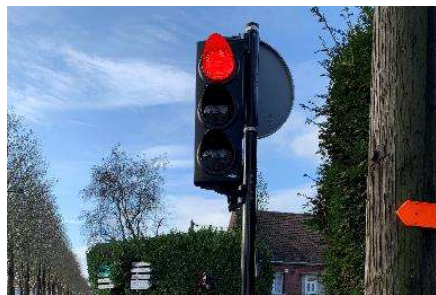
Signalisation lumineuse tricolore
