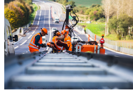
Dispositifs de retenue
